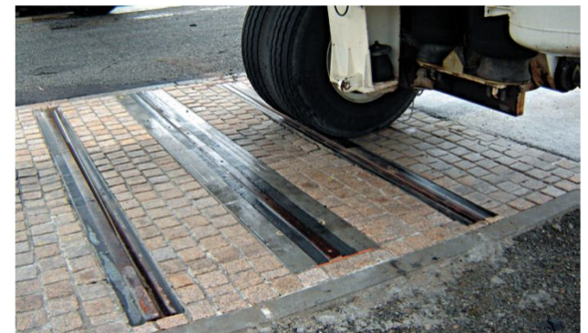
Structures pour tramways
